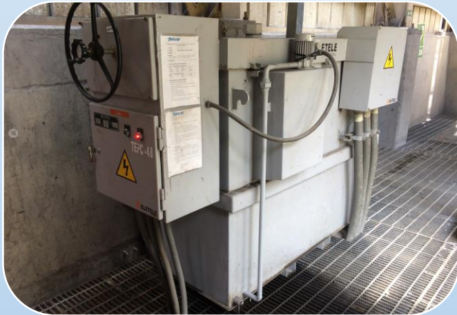
MIGRACIÓN DE CONTROLADOR DE REOSTATO DE MOLINO 900HP
